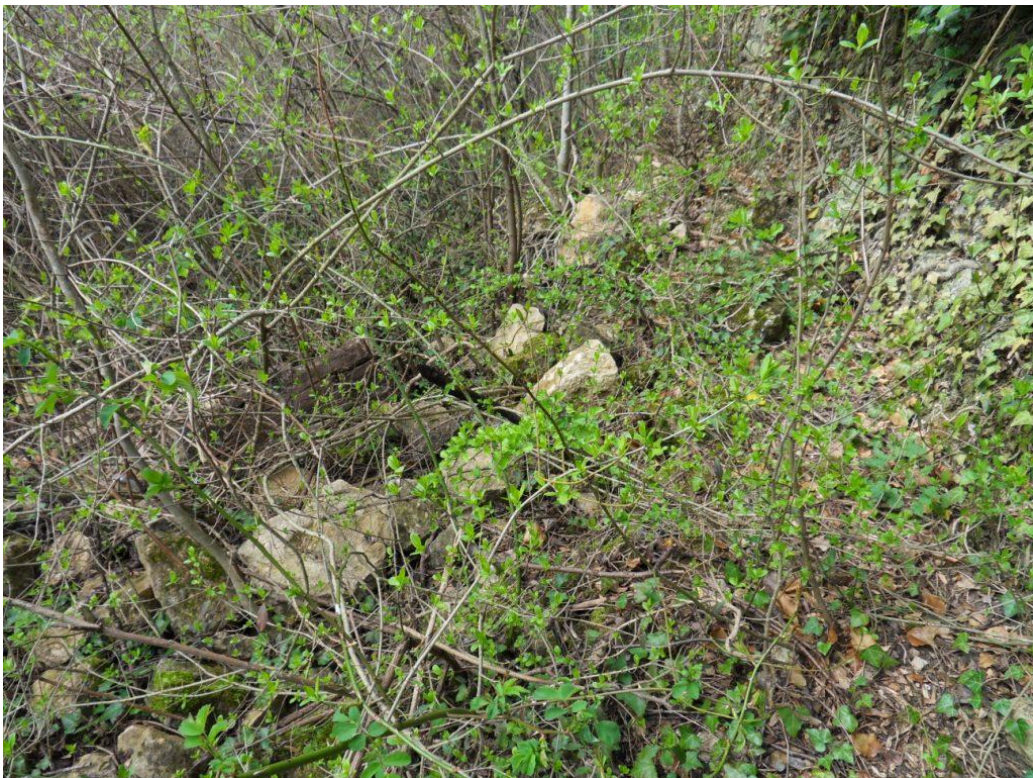
Photo 4 : Zone de propagation et blocs tombés en pied de mur.
