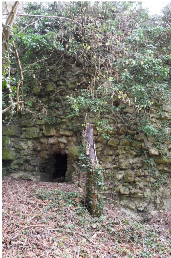
Photo 2 : Gros plan sur la partie ouest de la tour ( la plus démantelée).
