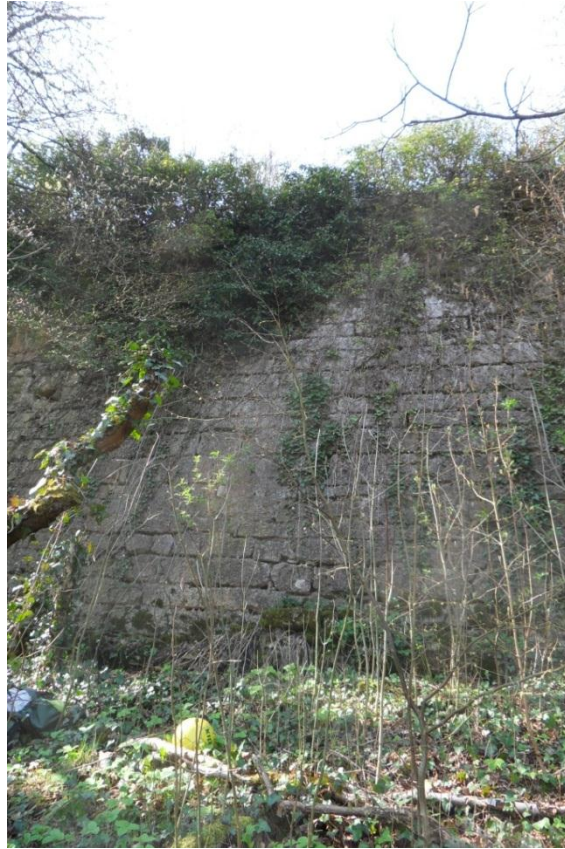
Photo 1 : Vue représentative de l'état du mur.
