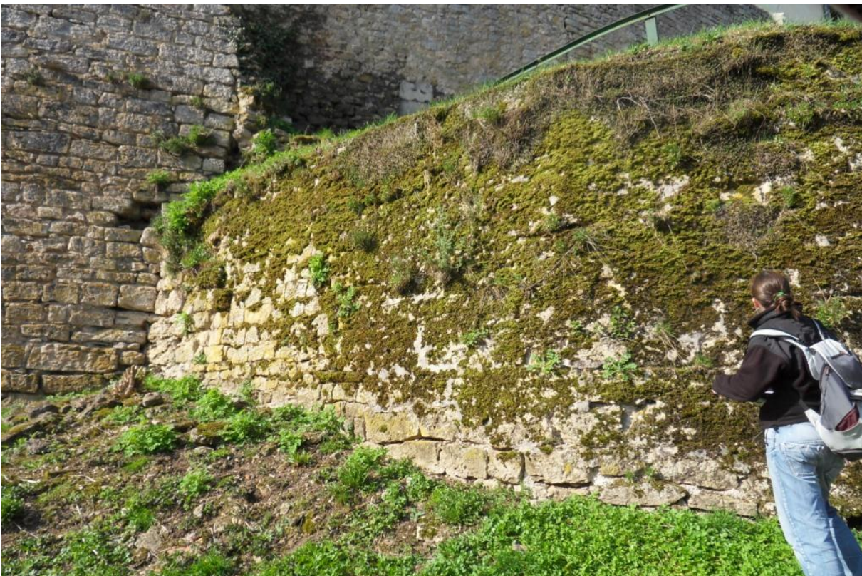
Photo 2 : Vue d'ensemble sur le mur perpendiculaire aux escaliers avec la végétation qui couvre l'ensemble.
