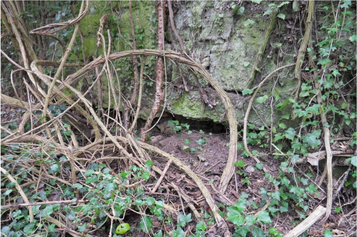
Photo 7 : Sous-cavage en partie masqué par la végétation.
