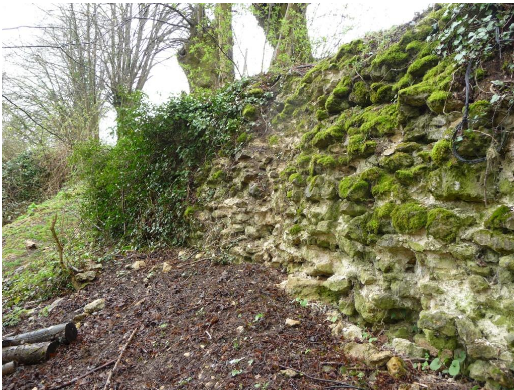
Photo 2 : Gros plan sur les dégradations du mur.
