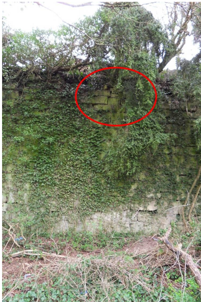
Photo 2 : Zone qui présente des blocs prêts à basculer au sommet du mur.
