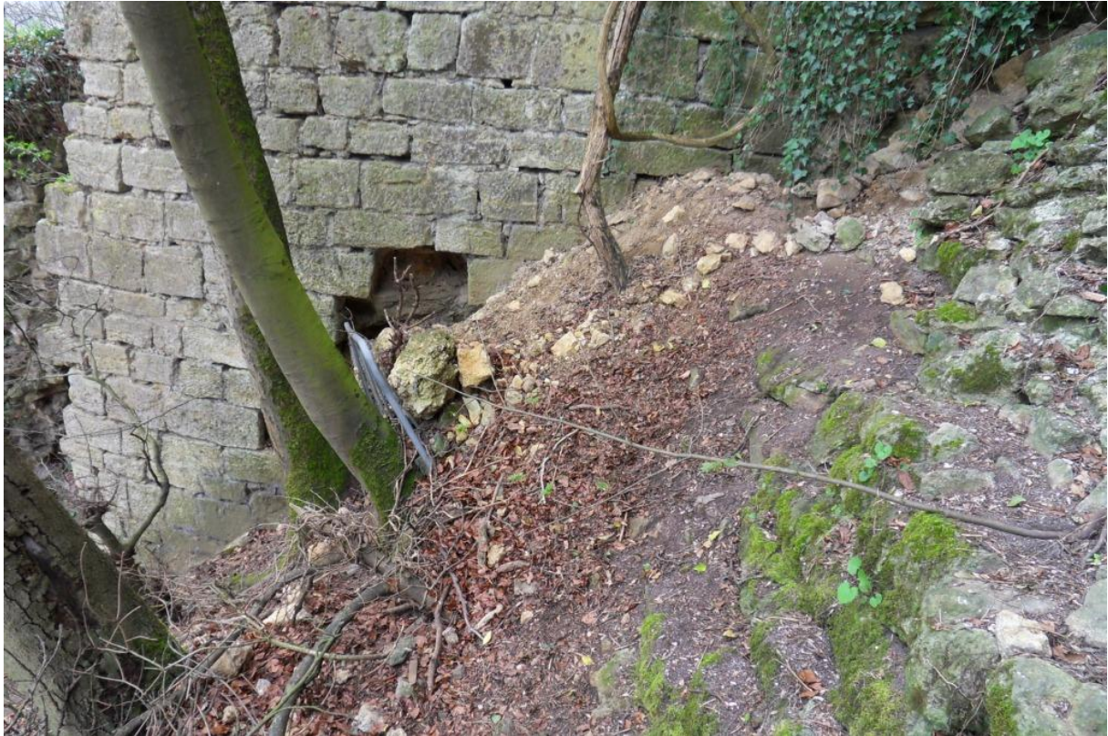
Photo 4 : Élément de barrière métallique retenant des blocs et sur le point d'être contournée.
