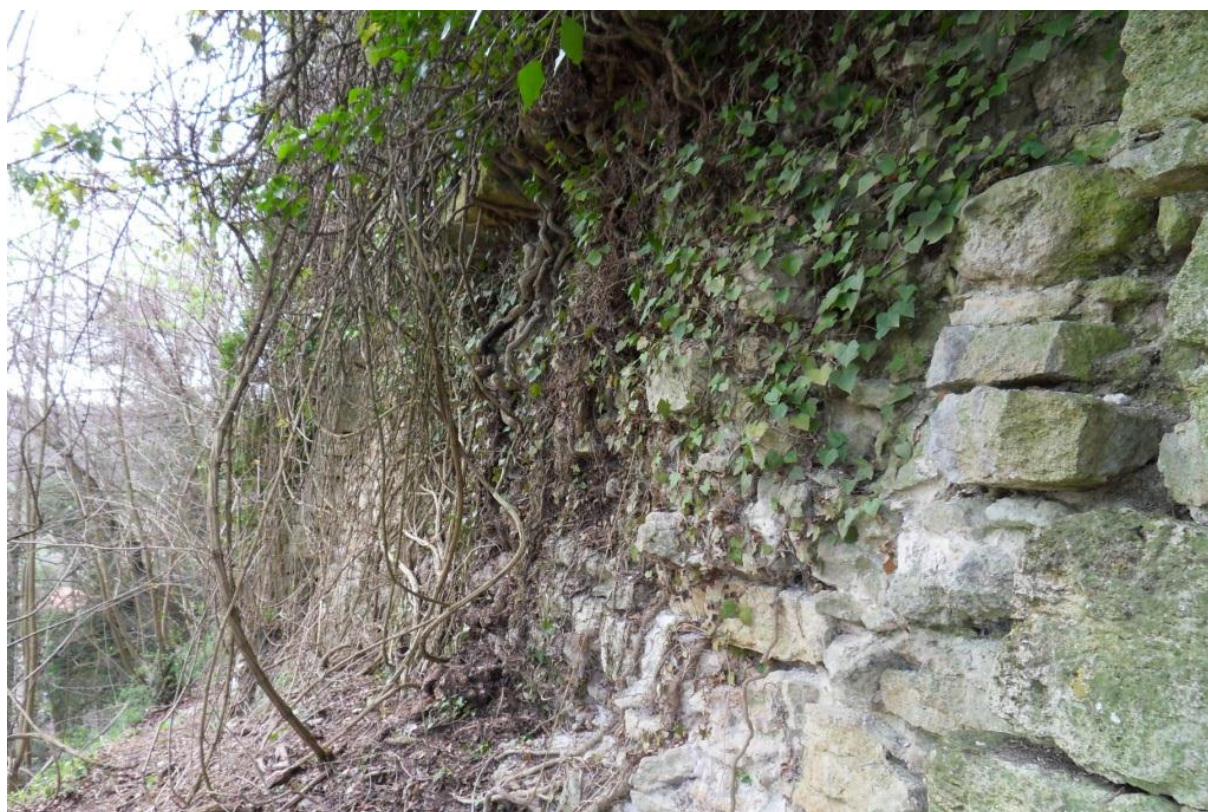
Photo 3 : Vue d'ensemble du « sous-cavage » de la partie sud.
