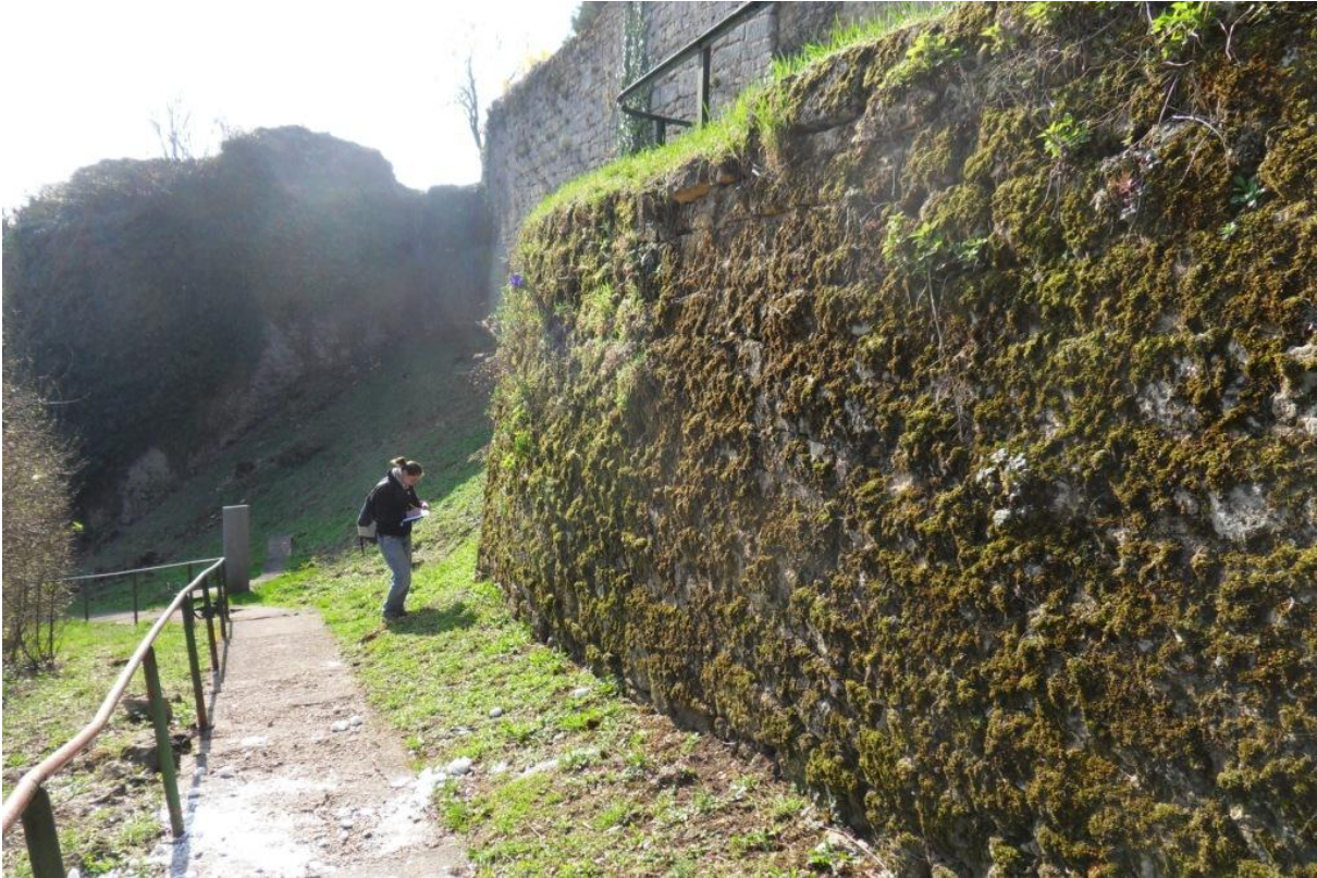
Photo 1 : Mur longeant les escaliers qui descendent au Calvaire et vue sur l'enjeu (chemin de passage).
