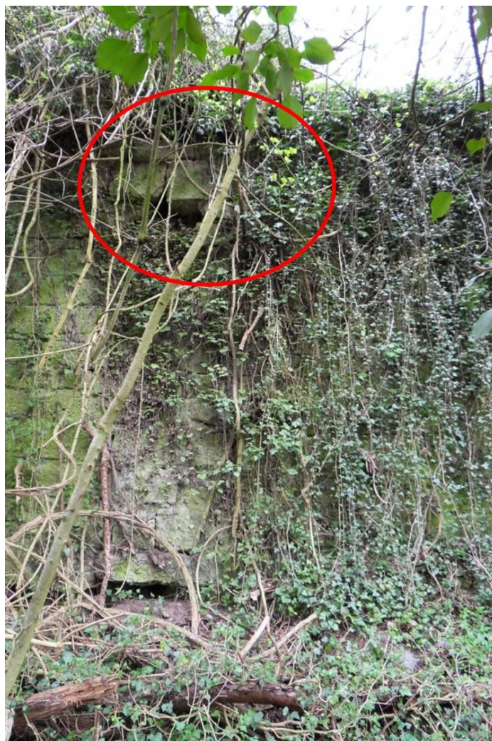
Photo 3 : Zoom sur des blocs prêts à basculer.
