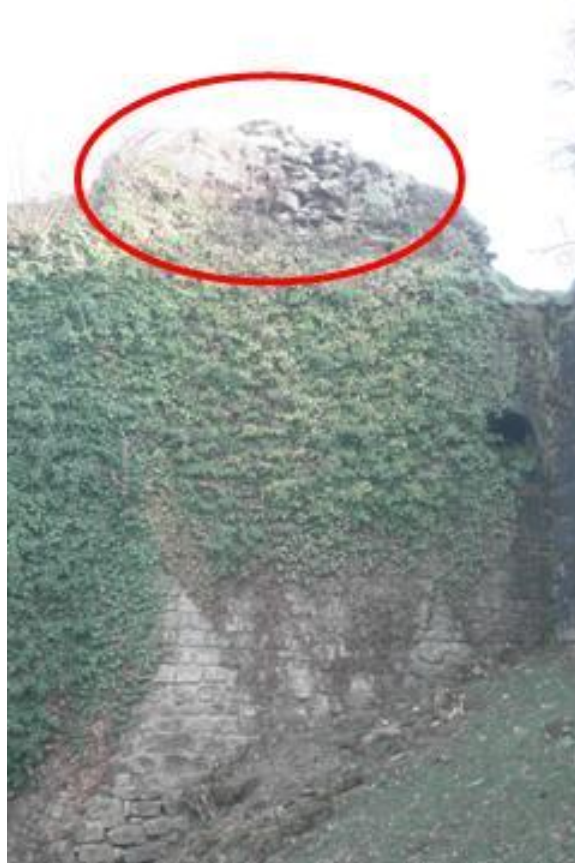
Photo 1 : Partie ouest de la tour : blocs instables au sommet de la tour.
