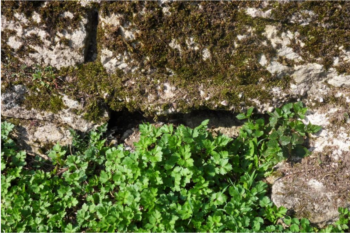
Photo 3 : Gros plan sur le ciment rongé entre les blocs et la végétation envahissant le mur.
