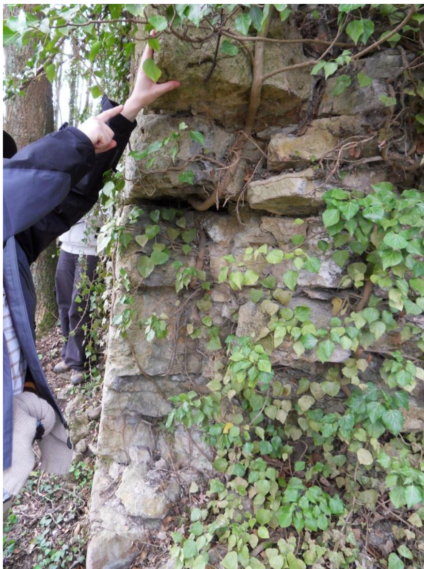
Photo 3 : Gros plan du sous cavage avec des blocs prêts à tomber.
