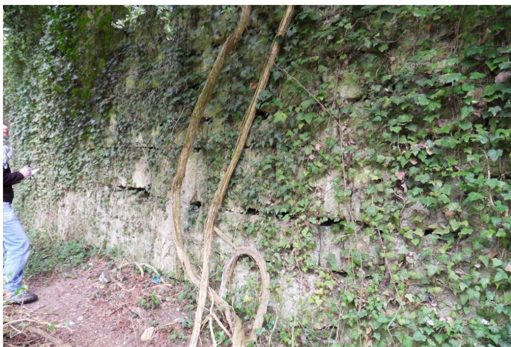
Photo 4 : Zoom sur le ciment érodé entre les blocs.
