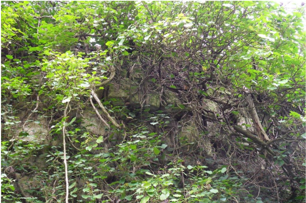
Photo 2 : Gros plan du sommet du mur « gonflé » par l'action de la végétation.
