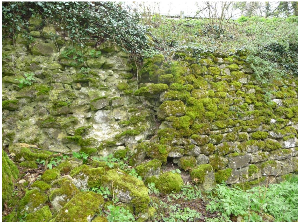
Photo 4 : Zone instable du mur.
