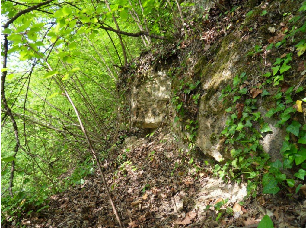
Photo 29 : Banc calcaire en surplomb avec un sous cavage de 30 cm de profondeur.
