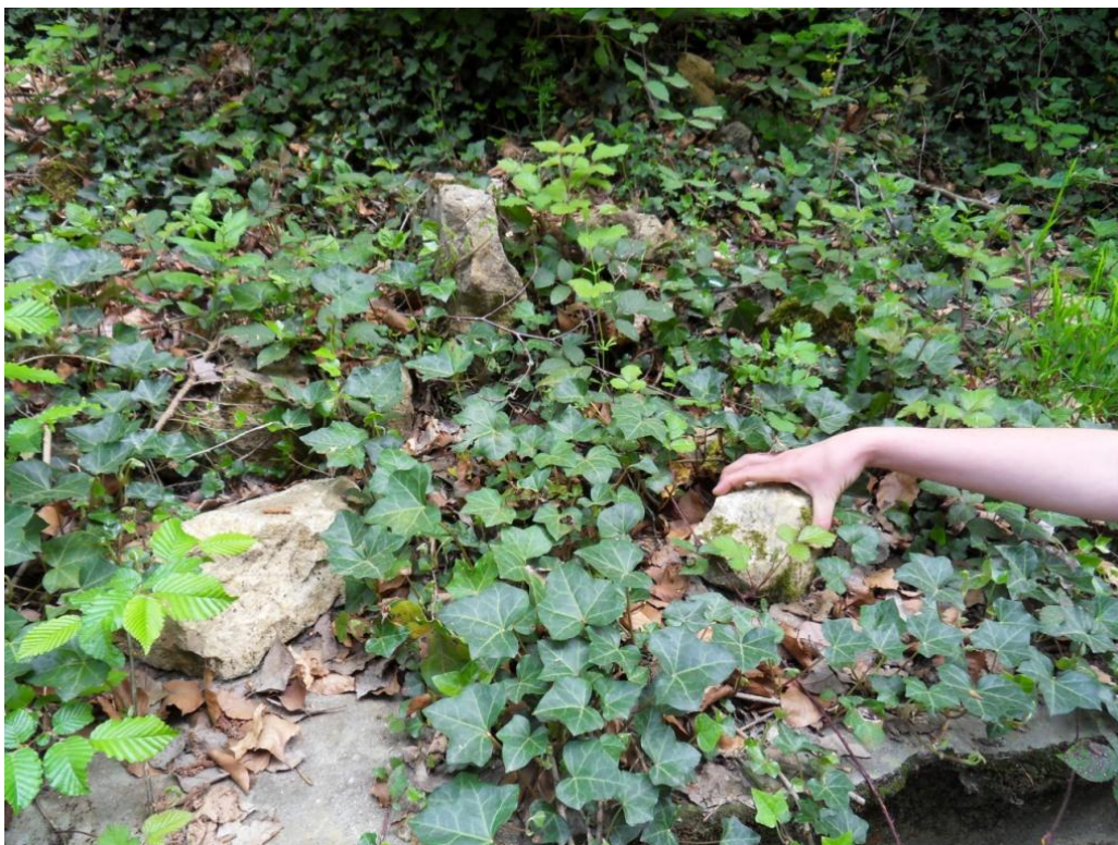
Photo 6 : Blocs chutés d'environ 5 kg au niveau du muret en bordure du trottoir.
