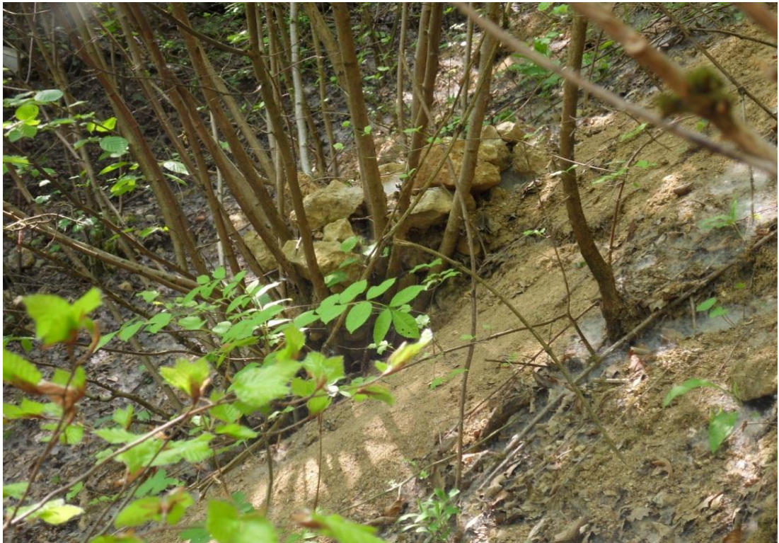
Photo 24 : Blocs/pierres chutés et stoppés par les arbustes (parcelles 23-24)
