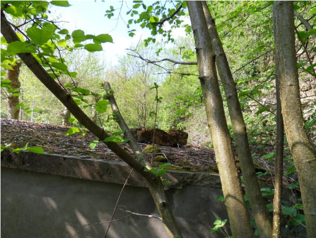
Photo 7 : Bloc tombé de 0,04 m 3 sur le toit du garage parcelle 790.
