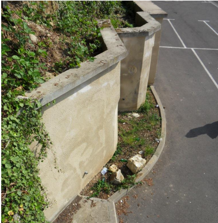
Photo 5 : Vue de blocs dont la chute n'a pas été stoppée par la fosse de réception.
