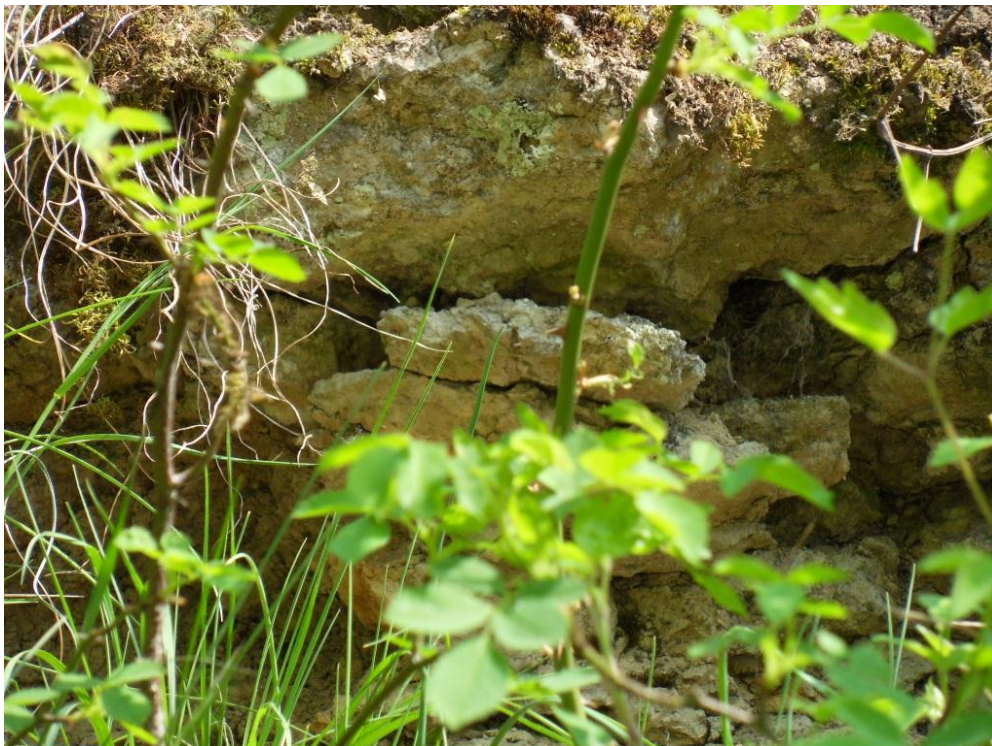
Photo 10 : Zoom sur des blocs instables.
