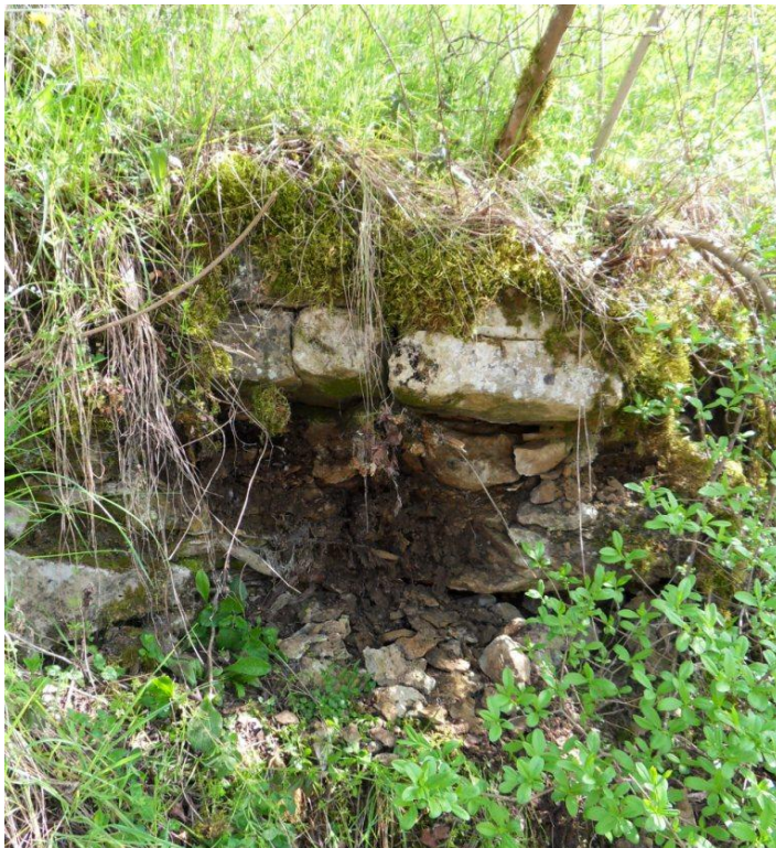
Photo 2 : Zoom sur un sous cavage de 30 cm de profondeur.
