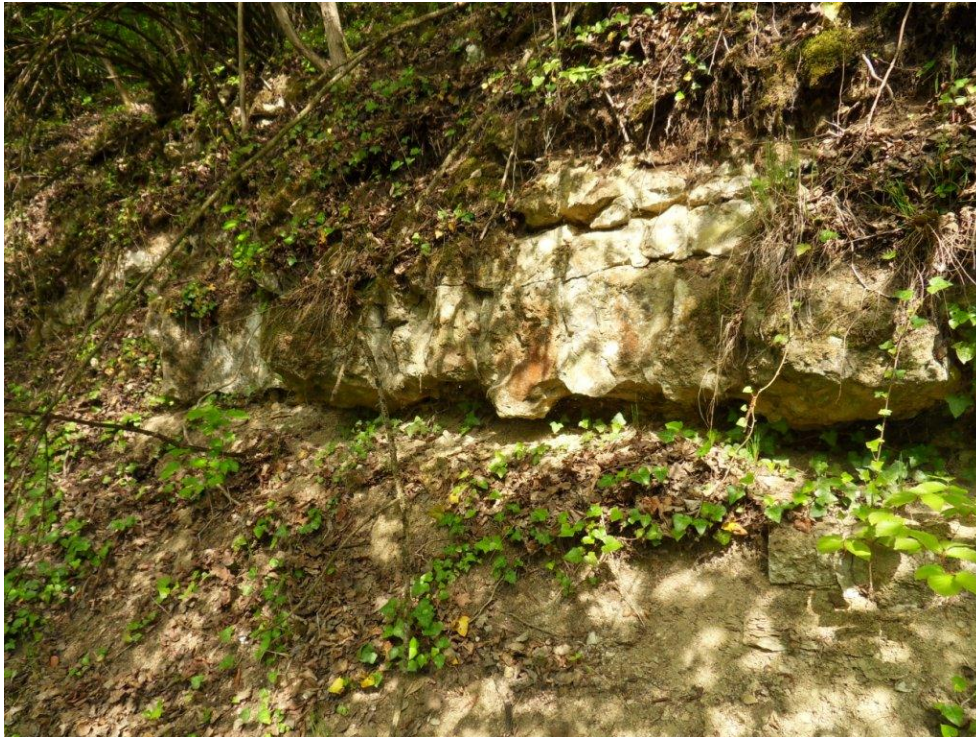
Photo 4 : Banc calcaire avec présence de sous-cavage.
