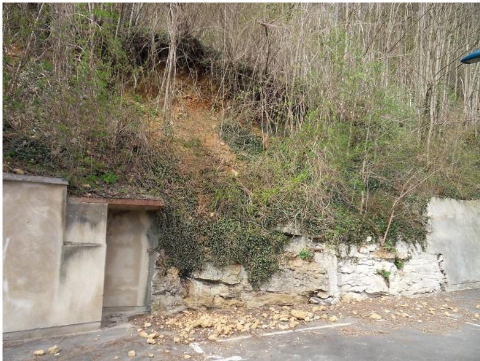
Photo 6 : Talus d'éboulis avec pierres et petits blocs qui chutent sur le parking (côté ouest).
