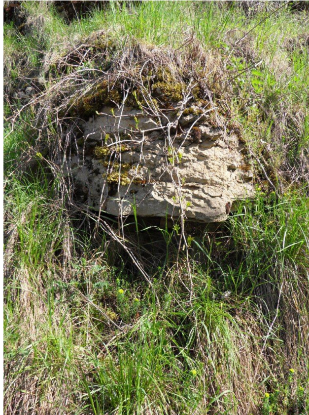
Photo 4 : Bloc instable de 0,6 m 3 au niveau de l'intersection entre les rues de Ravenne et du Général Leclerc.
