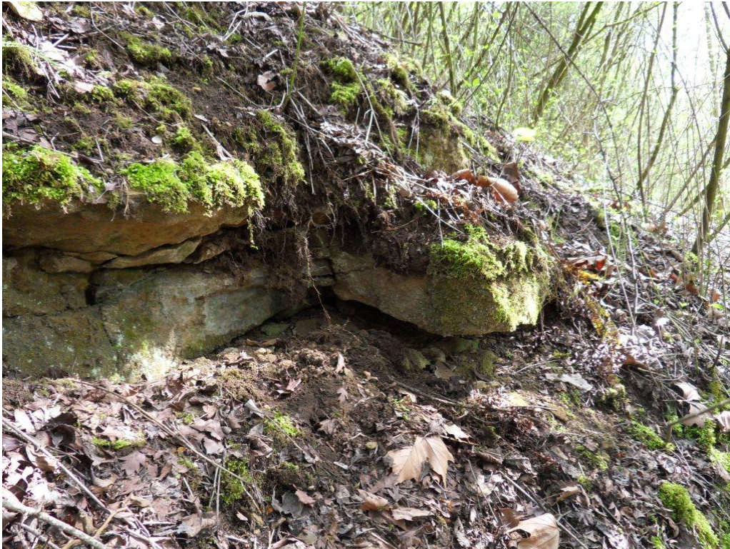
Photo 19 : Sous cavage et bloc susceptible de glisser (corniche supérieure).
