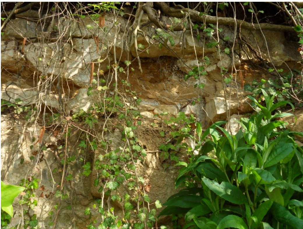
Photo 2 : Vues de blocs instables.
