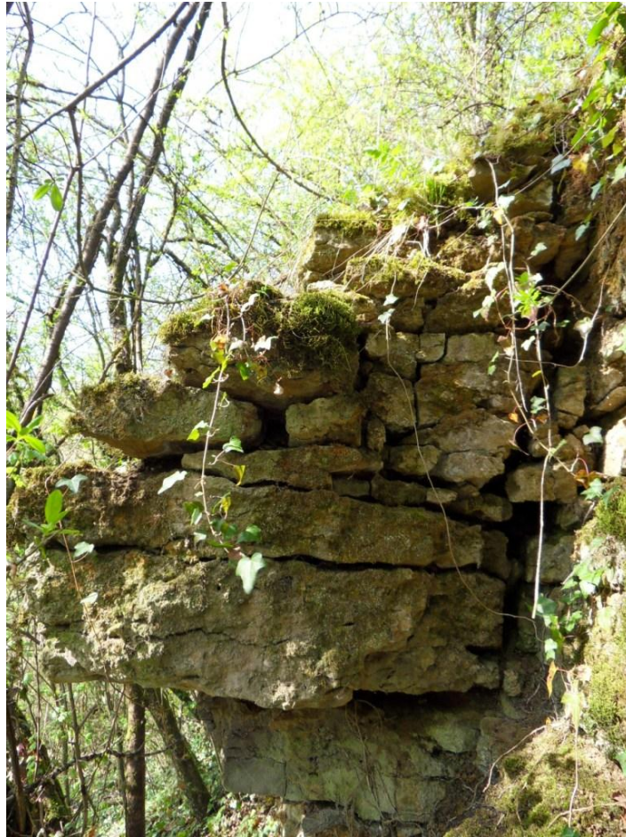
Photo 21 : Sous cavage et blocs instables désolidarisés par des fractures (corniche supérieure).
