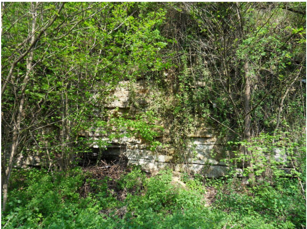
Photo 2 : Sous-cavage en base d'escarpement.
