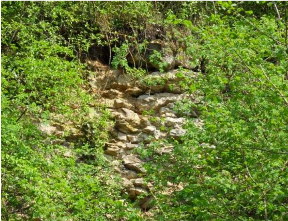
Photo 3 : Zone fracturée dans la partie supérieure de l'escarpement (entre 5 et 8 m de hauteur) derrière le terrain de pétanque.
