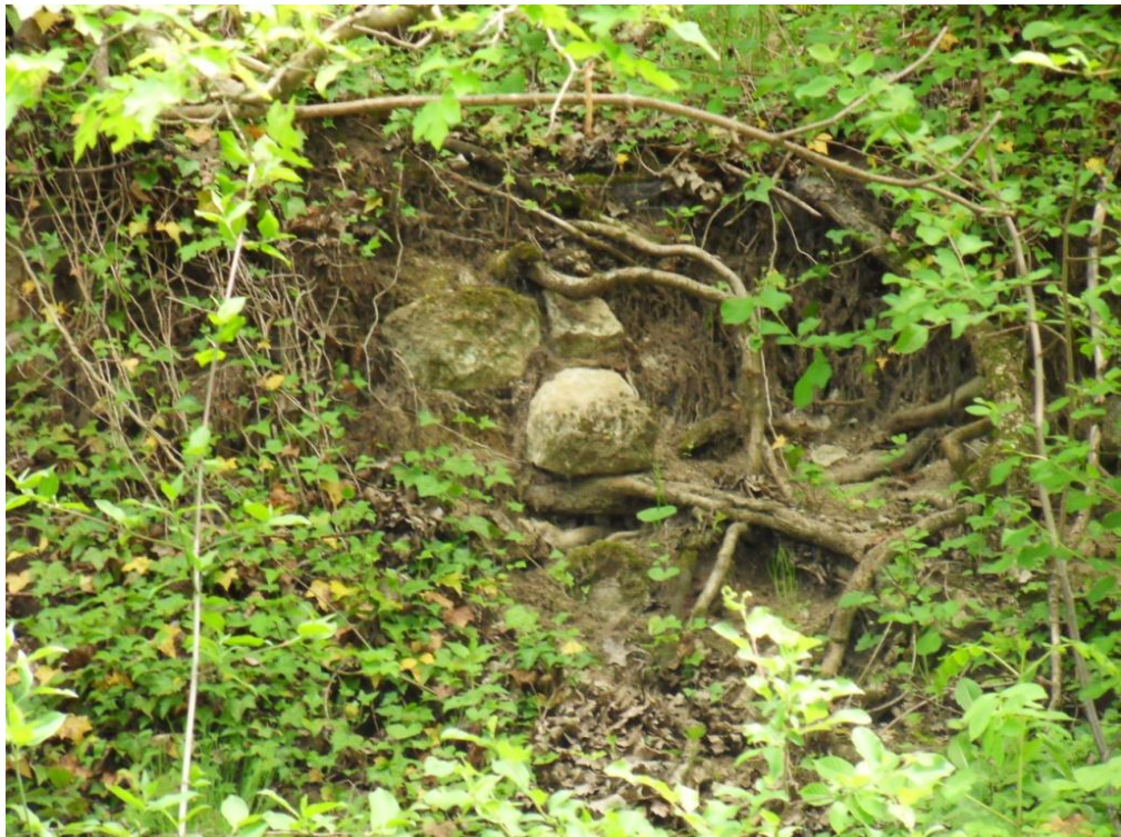
Photo 3 : Pierres instables de 2 à 3 kg.
