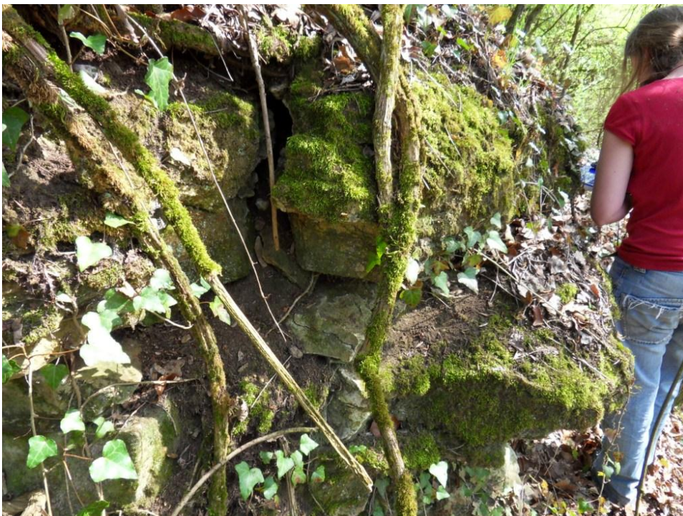
Photo 20 : Fracture ouverte (corniche supérieure).
