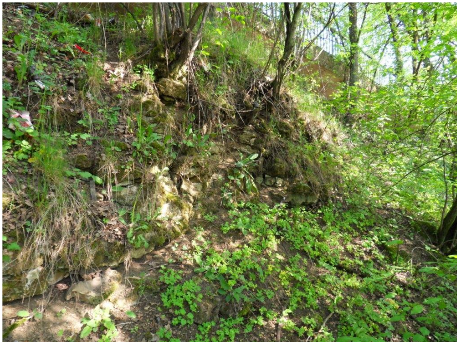
Photo 6 : Vue de l'état de démantèlement de la corniche.
