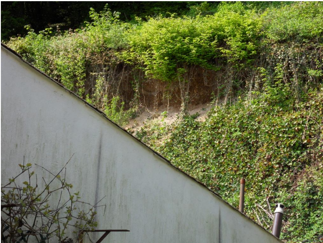
Photo 26 : Vue de la partie sommitale qui subit une érosion régressive (parcelles 36).
