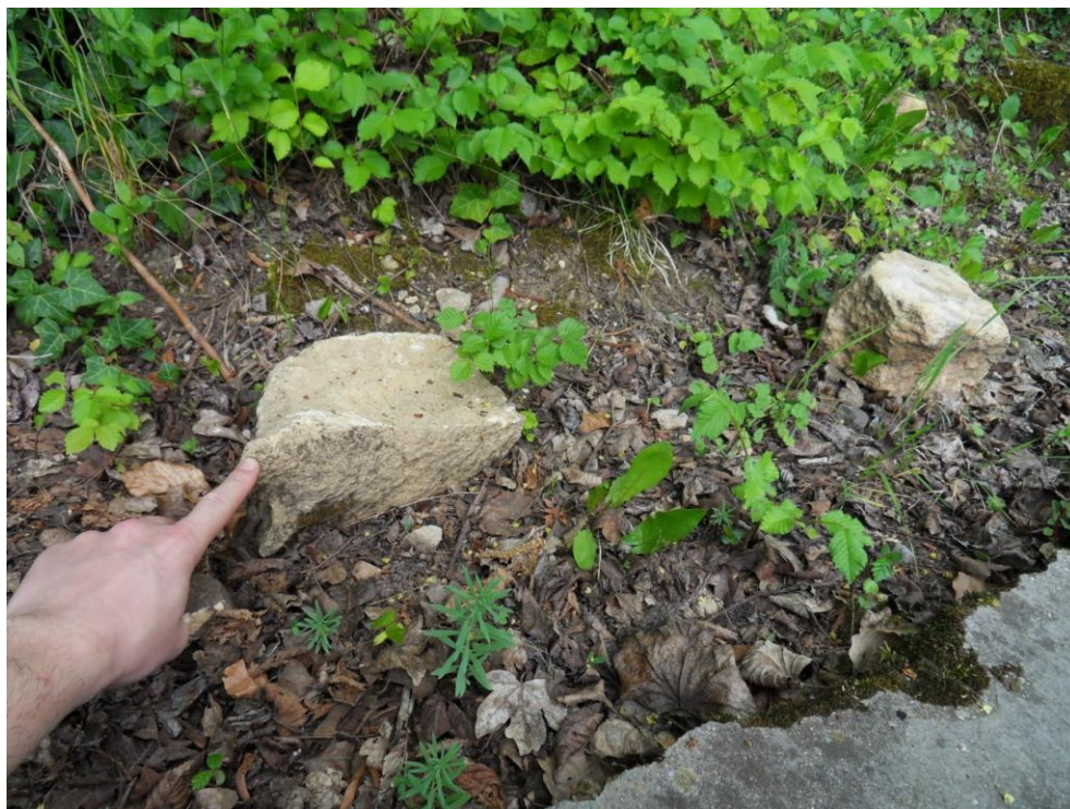
Photo 7 : Pierres chutées de 2 à 3 kg au niveau du muret en bordure du trottoir.
