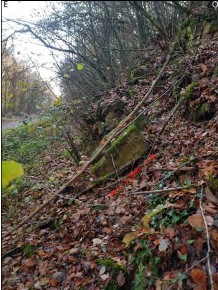
Illustration 13 - Photo de l'éboulement identifié au niveau de l'affleurement A21 surplombant la voie verte. Bloc de référence d'environ 360 L au premier plan. Photo BRGM (2021)
